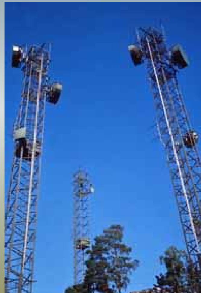
Antenntorn med olika typer av parabolantennor
